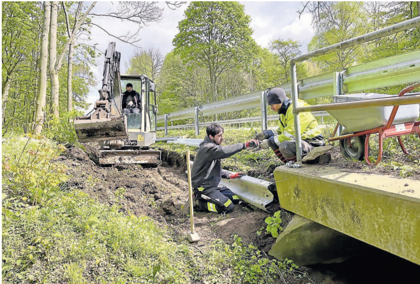
Bei der Verlängerung des Leitsystems in Richtung Vienenburg half auch ein Baufahrzeug.
